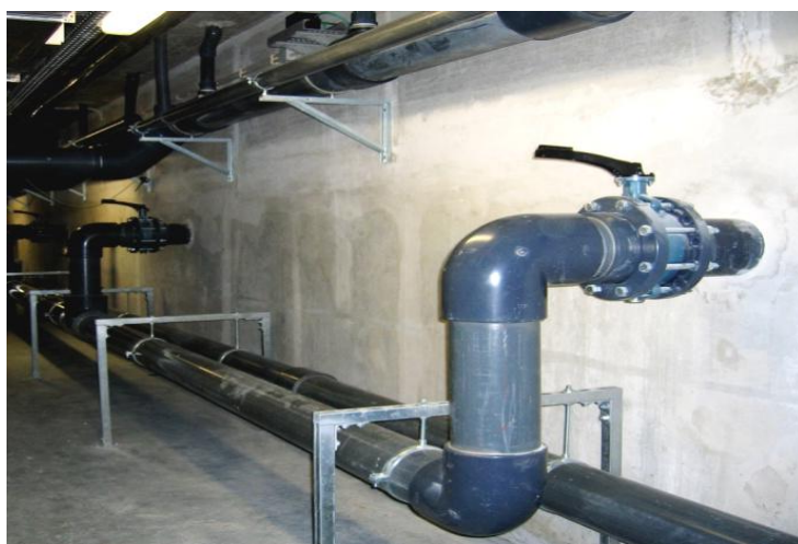
Fig. 5 – Circuito de distribuição da água tratada instalado nas paredes laterais da piscina
